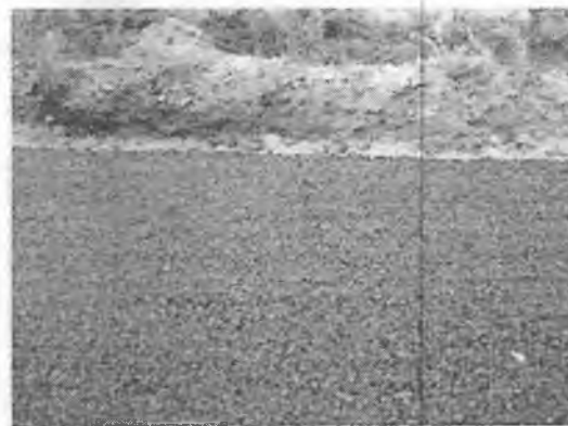
Figura 04: Vista em detalhe destacando o aspecto da superfície da camada de CPA.
