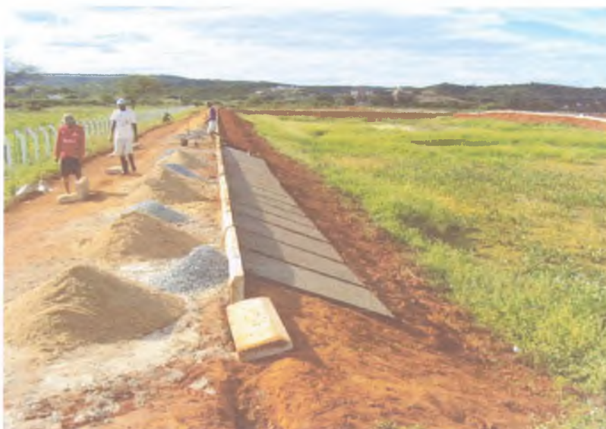
FIG – 02 – SERVIÇOS NAS ESTAÇÕES DE TRATAMENTO, ATERRO PARA REGULARIZAR TALUDES E COROAMENTO, PROTEÇÃO DOS TALUDES E MEIO FIO E ESTACAS EM CONCRETO PRÉ-MOLDADO.
