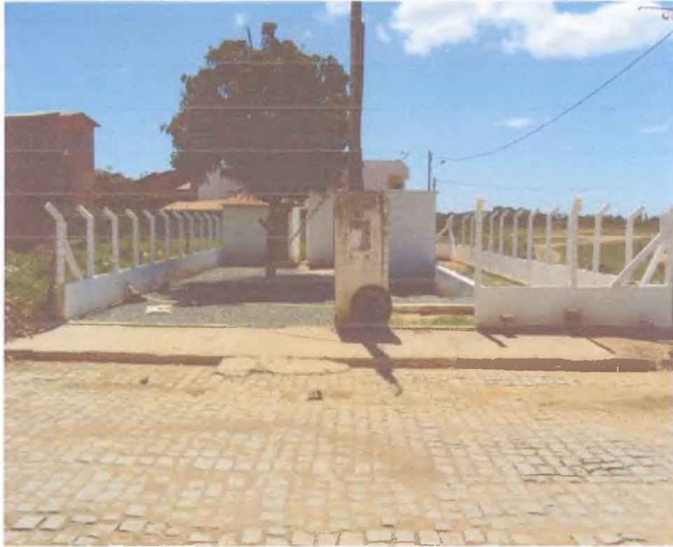
FIG – 04 – SERVIÇOS NA ESTAÇÃO ELEVATÓRIA PRINCIPAL, EXECUÇÃO DE MURETA, LIMPEZA, NOVO ARAME FARPADO, EXECUÇÃO DE DEPÓSITO COBERTO, LASTRO DE BRITA E PINTURA.
