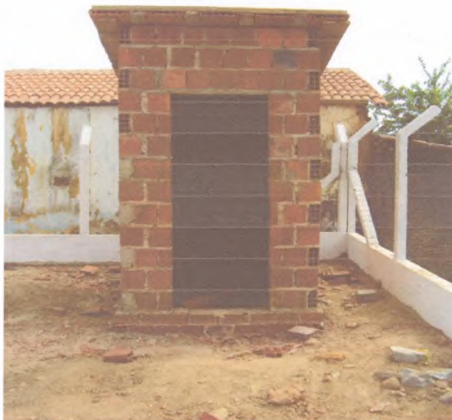
FIG – 10 – CASA DO QUADRO DE COMANDO DAS BOMBAS DA ESTAÇÃO ELEVATÓRIA 04
