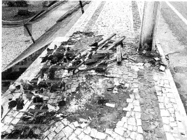
Imagem 01. Avarias no piso
