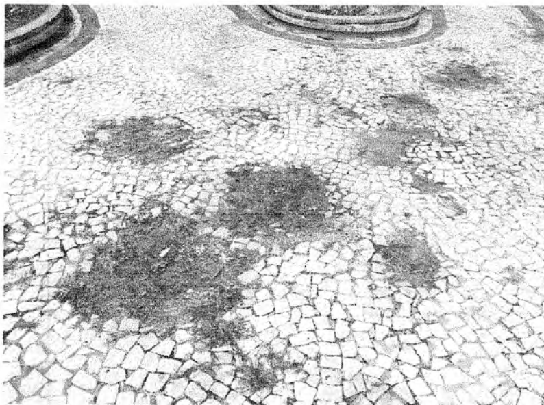
Imagem 02. Avarias no piso
