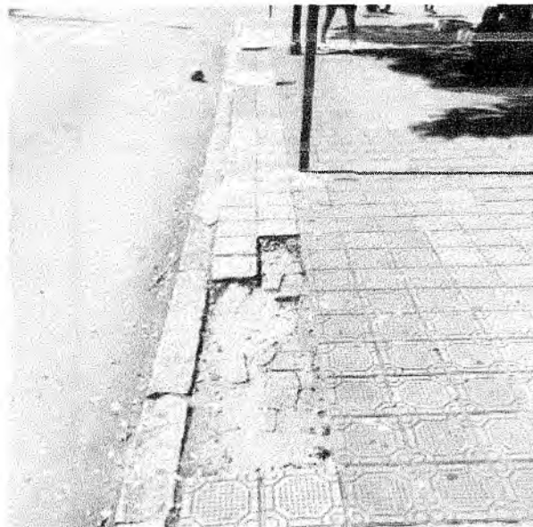
Imagem 02. Avarias no piso
