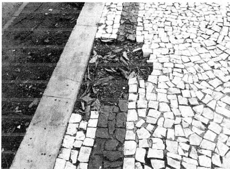
Imagem 03. Avarias no piso
