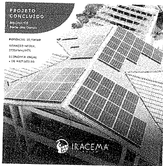
Porto das Dunas - 20,71kWp
