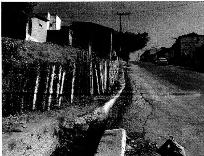
FIGURA 13. PC-03 - LANÇAMENTO DE ESGOTO A CÉU ABERTO.
