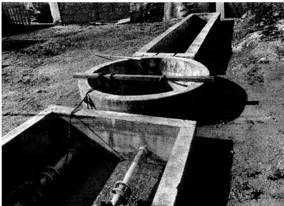
FIGURA 29. TRATAMENTO PRELIMINAR E ESTAÇÃO ELEVATÓRIA.
