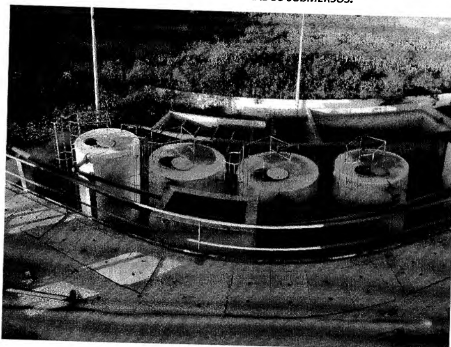
FIGURA 50. FILTROS AERADOS SUBMERSOS.
