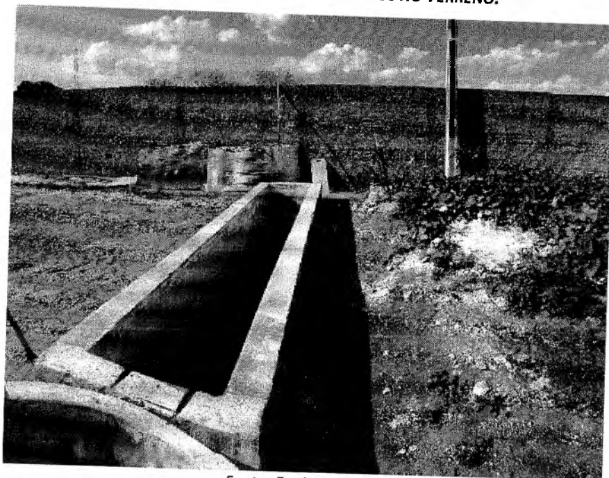
FIGURA 30. RESÍDUOS DISPOSTOS NO TERRENO.
