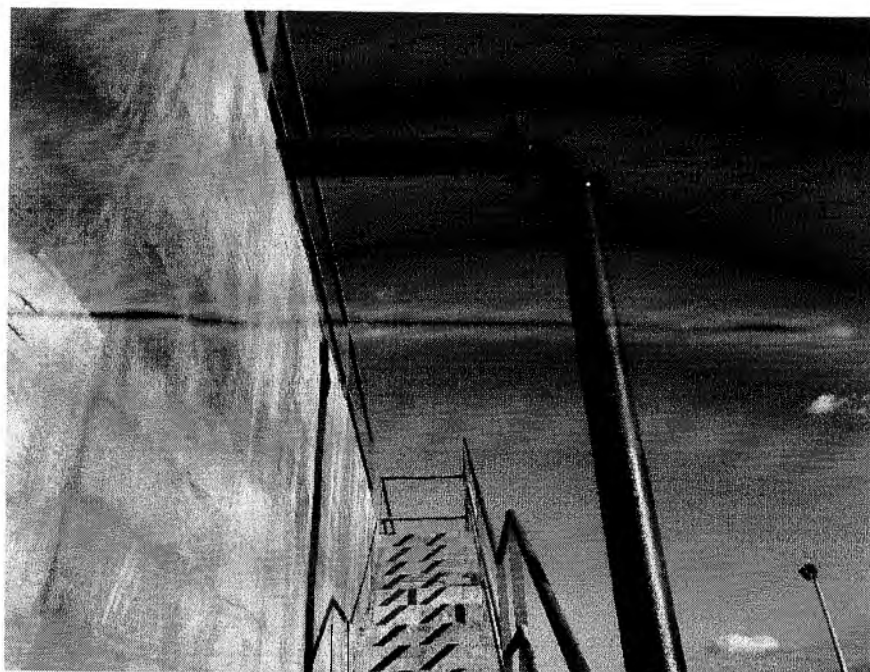
FIGURA 46. CHEGADA DE ESGOTO NO REATOR UASB.
