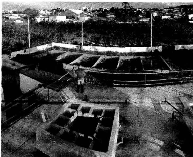
FIGURA 59. VISTA GERAL DOS LEITOS DE SECAGEM.
