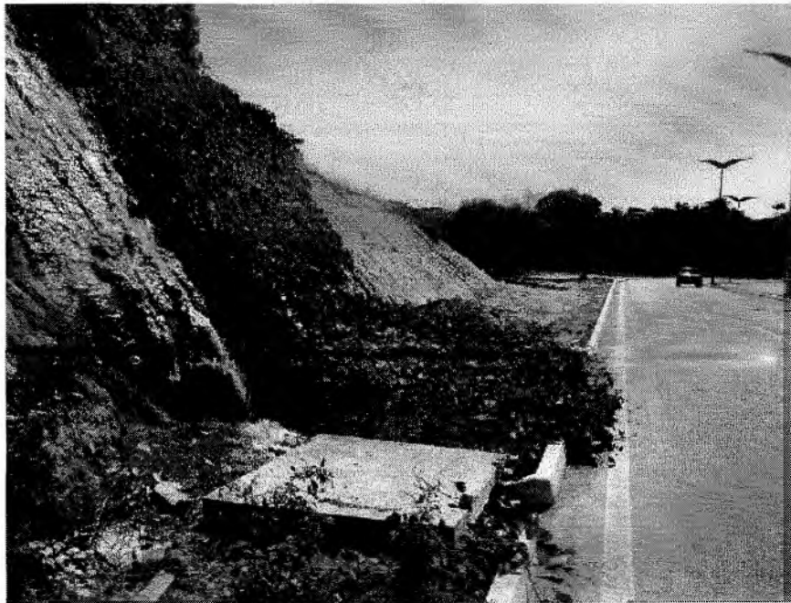
FIGURA 10. PC-01 - LANÇAMENTO DE ESGOTO A CÉU ABERTO.
