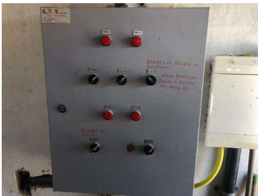
FIGURA 39. PAINEL ELÉTRICO DA ETE.
