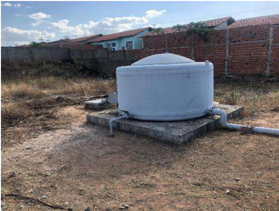
FIGURA 34. TANQUE DE CONTATO.
