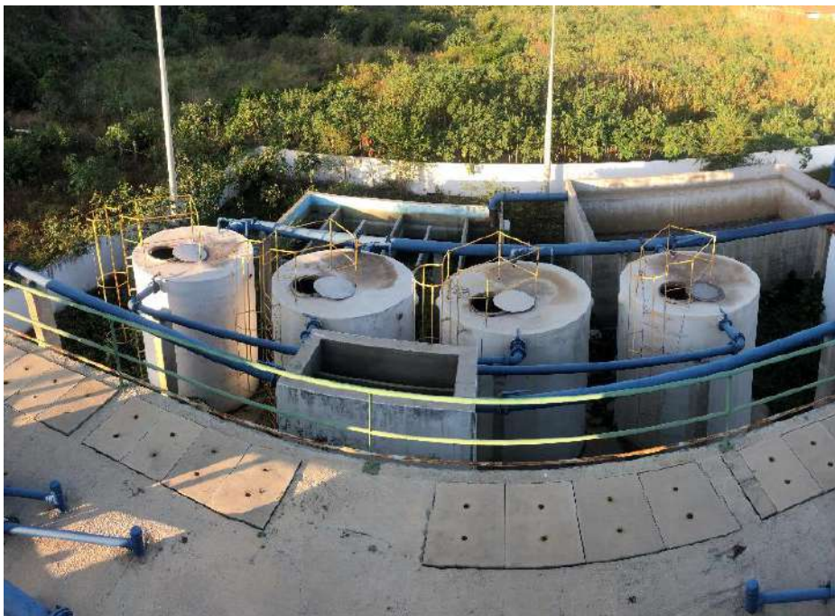
FIGURA 50. FILTROS AERADOS SUBMERSOS.
