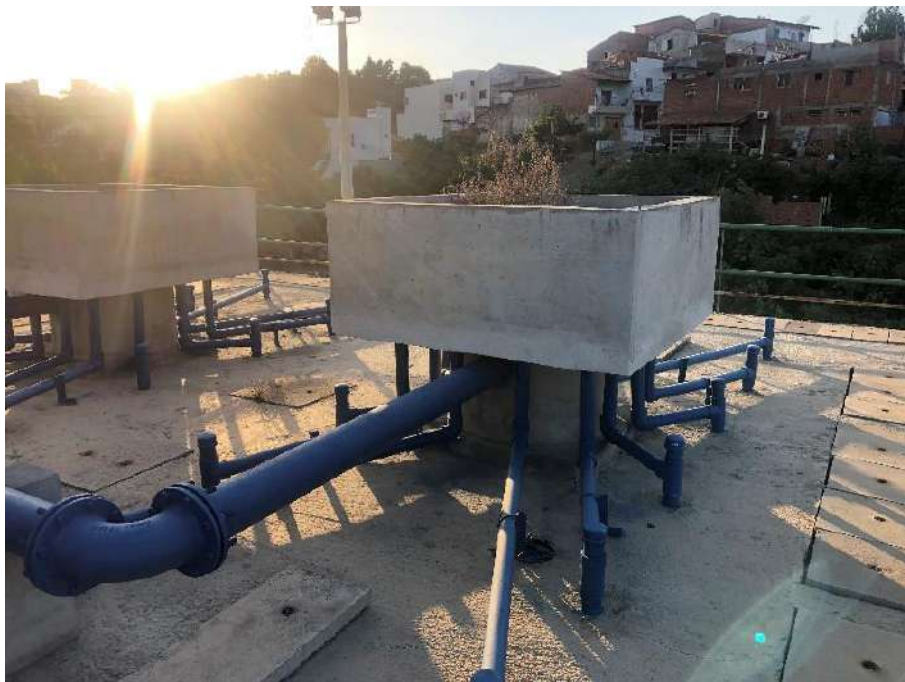
FIGURA 48. CAIXA DE DISTRIBUIÇÃO DE VAZÃO.
