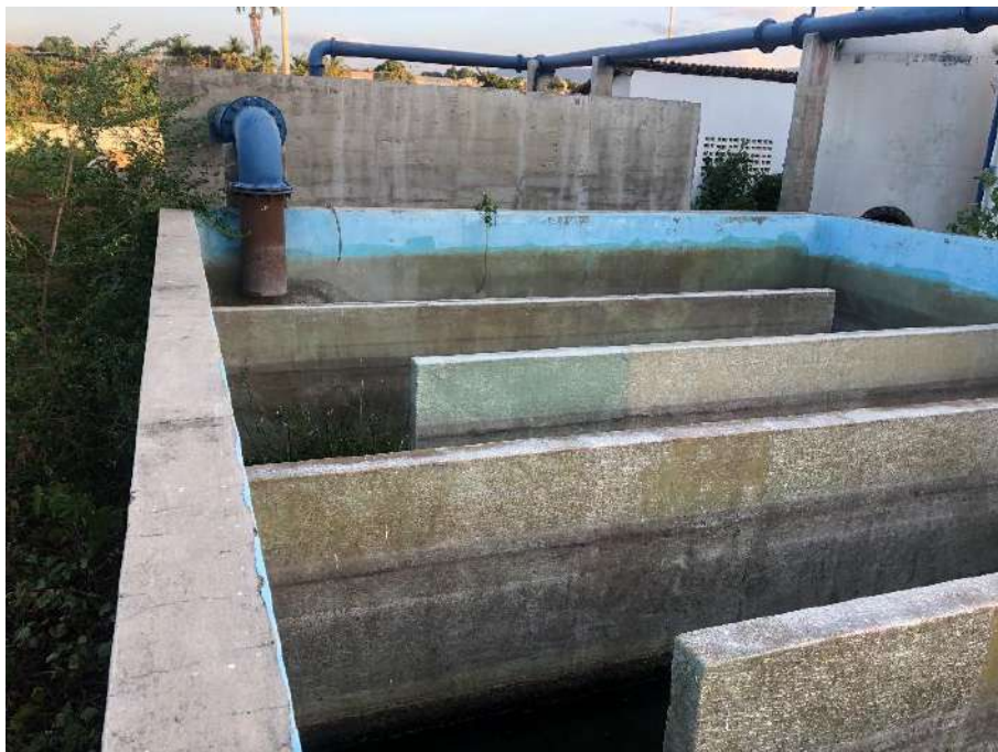
FIGURA 52. DECANTADOR E TANQUE DE CONTATO.
