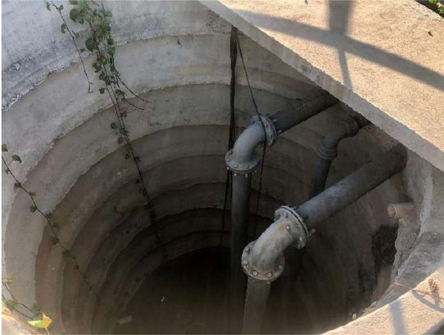
FIGURA 45. POÇO DE SUÇÃO DE EEE.
