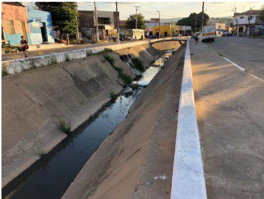
FIGURA 21. PC-09 - LANÇAMENTO DE ESGOTO NO RIO GRANJEIRO.
