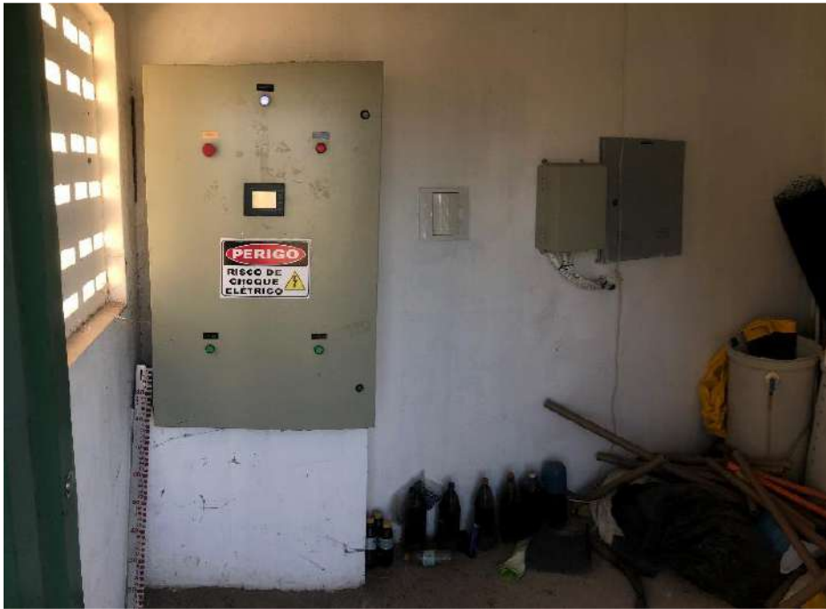
FIGURA 57. SALA DOS PAINÉIS.
