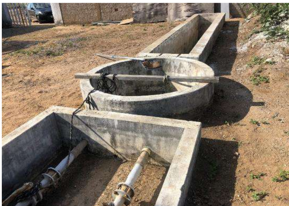
FIGURA 29. TRATAMENTO PRELIMINAR E ESTAÇÃO ELEVATÓRIA.
