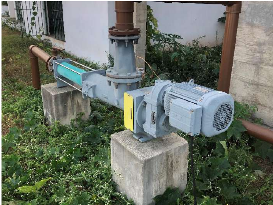
FIGURA 58. BOMBA DE EXCESSO DE LODO.
