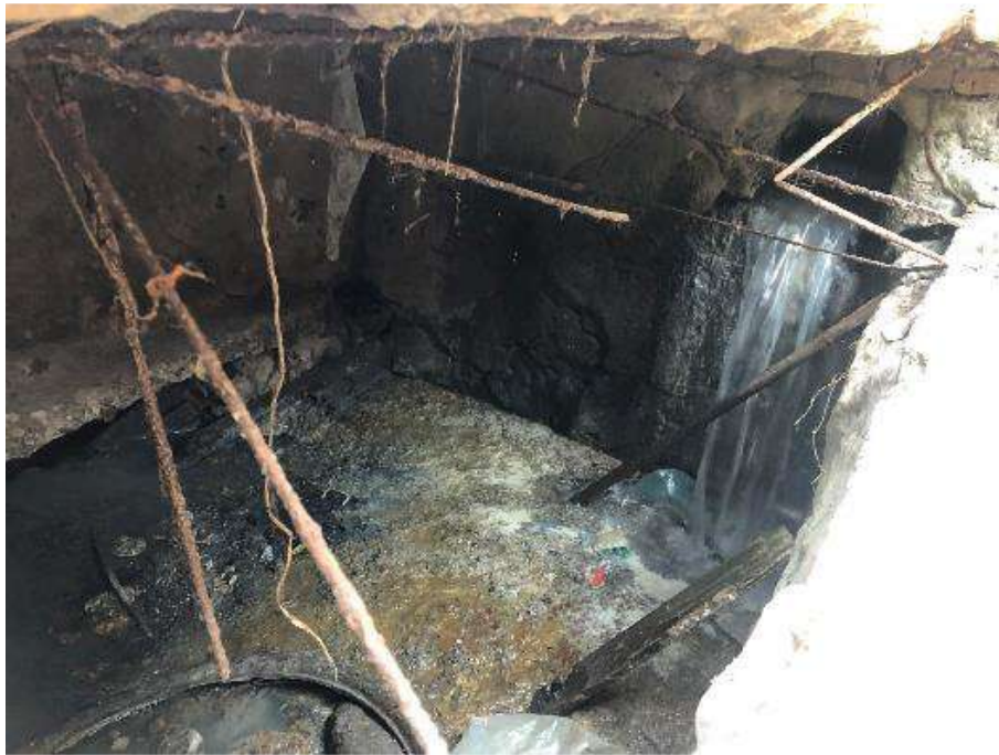
FIGURA 12. PC-02 – BY-PASS DA ETE VITÓRIA NOSSA - DESATIVADA.
