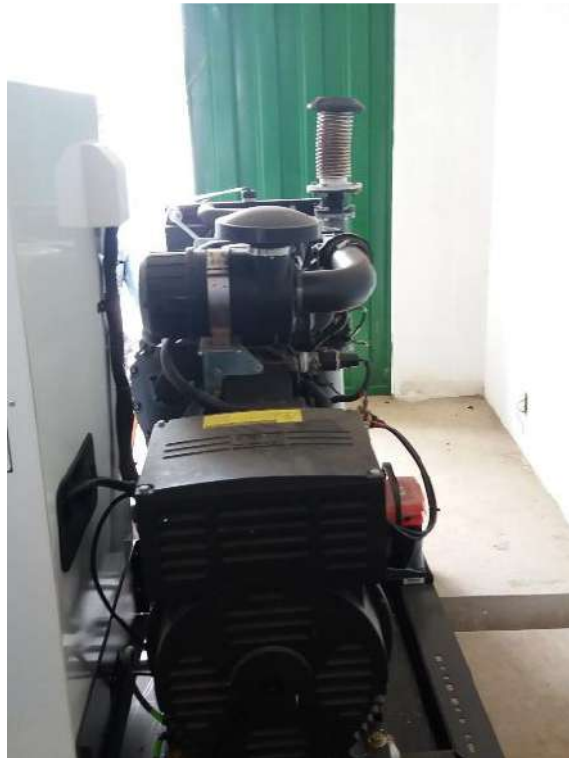
FIGURA 55. CASA DO GERADOR.
