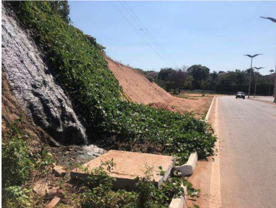
FIGURA 10. PC-01 - LANÇAMENTO DE ESGOTO A CÉU ABERTO.
