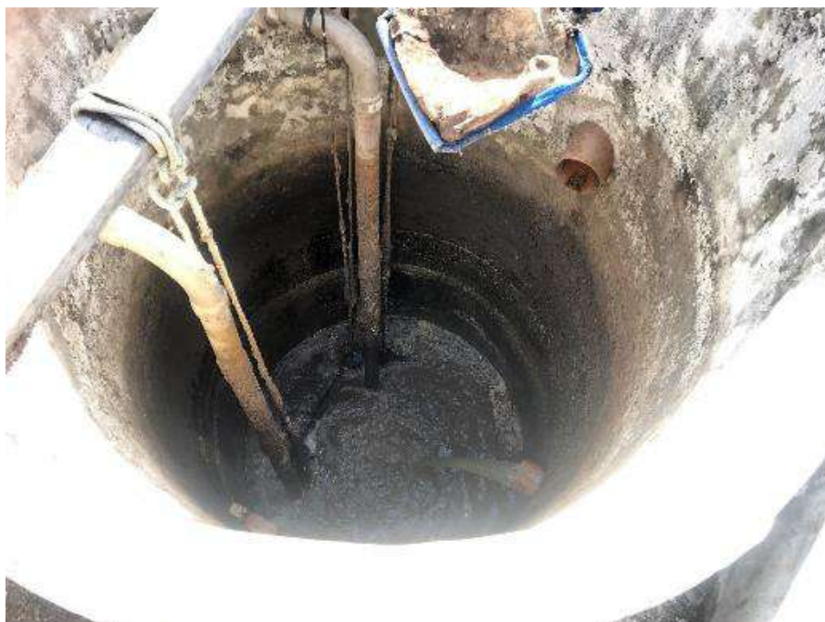
FIGURA 28. ESTAÇÃO ELEVATÓRIA DE ESGOTO.
