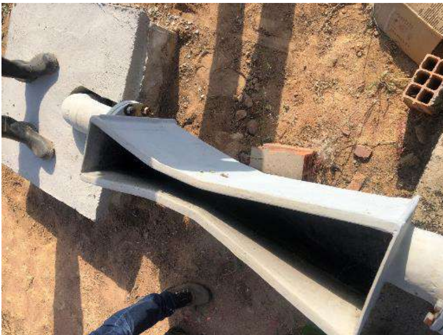
FIGURA 35. CALHA PARSHALL DE SAÍDA PARA MEDIÇÃO DE VAZÃO.
