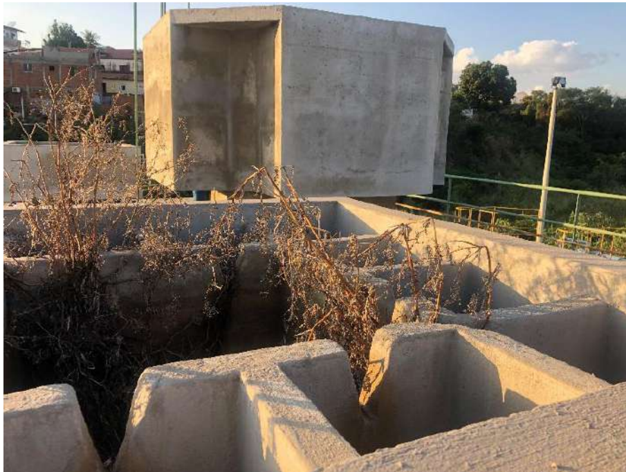
FIGURA 49. CAIXA DE DISTRIBUIÇÃO DE VAZÃO.
