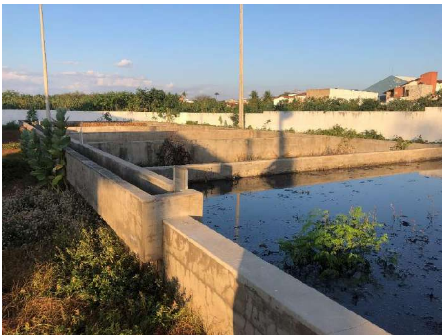
FIGURA 60. LEITOS DE SECAGEM.
