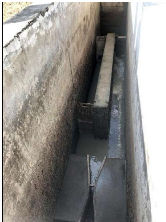
FIGURA 27. TRATAMENTO PRELIMINAR E CALHA PARSHALL DE ENTRADA.
