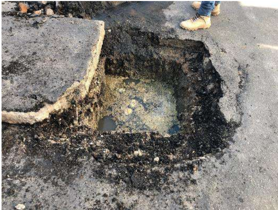
FIGURA 18. PC-07 – REDE COLETORA OBSTRUÍDA.
