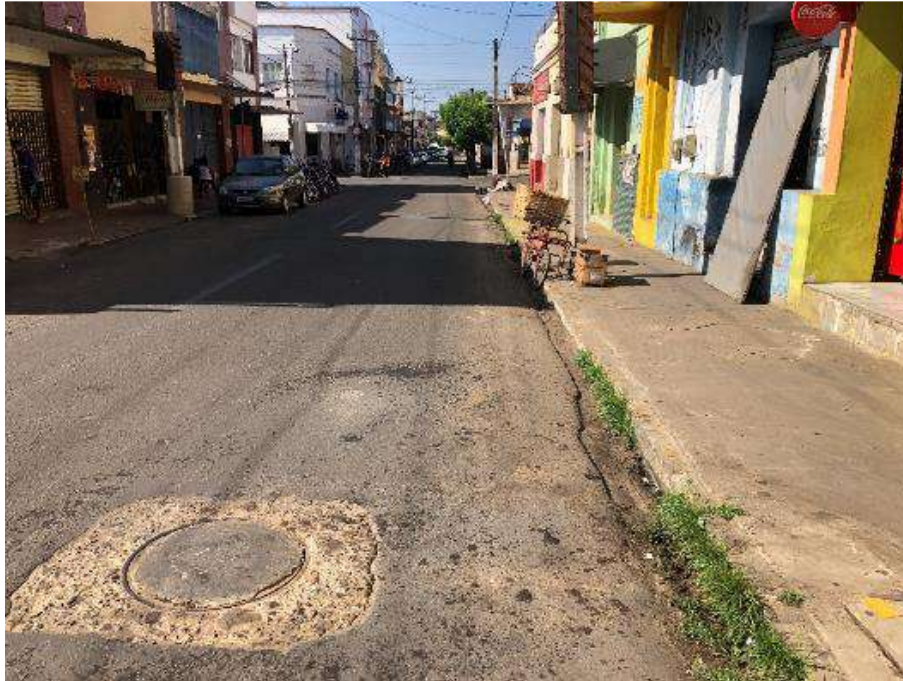
FIGURA 16. PC-06 – RUA COM FREQUENTE PONTO DE MANUTENÇÃO NA REDE COLETORA.
