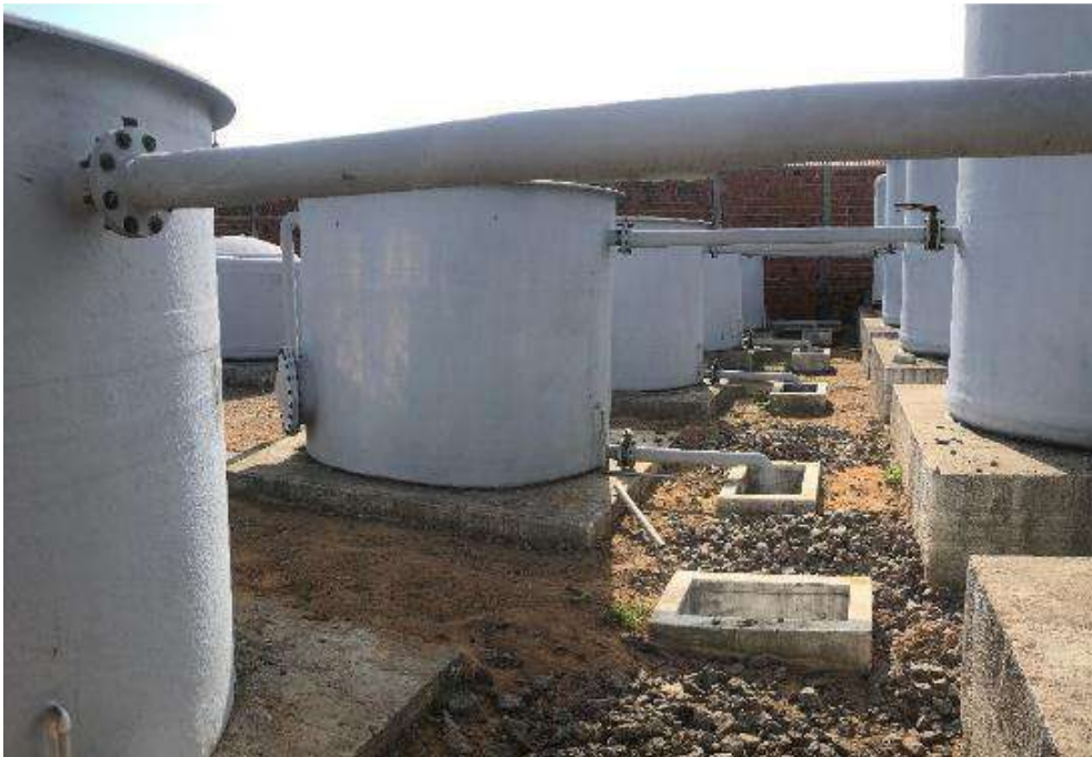
FIGURA 32. VISTA GERAL DOS REATORES AERÓBIOS E DECANTADORES.
